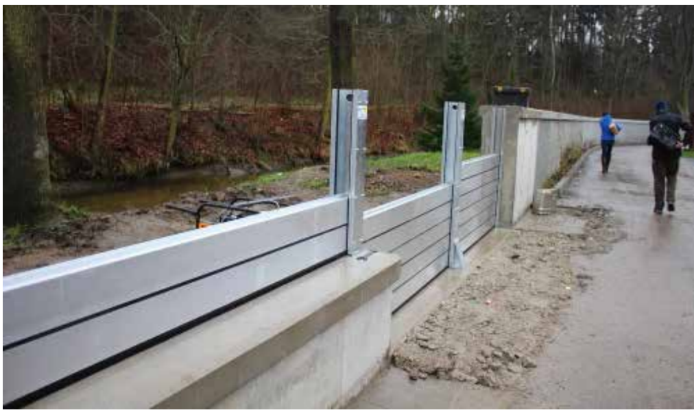
EN UDBYGGELSESMULIGHED FOR MURENE ER AT FORBEREDE IMPLEMENTERING AF I-PROFILER I MUREN UNDER DETAILFASEN, SÅ DISSE ENKELT KAN UDVIDES I HØJDEN. FOTO VISER OPBYGNINGEN AF 'STOP LOGS'
